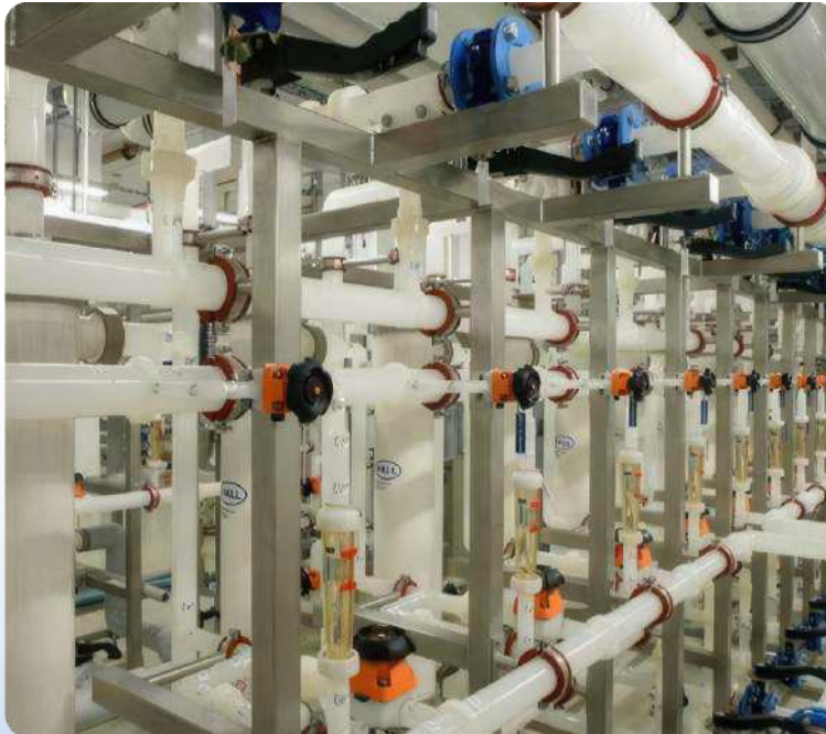
UPW üretim tesisi
